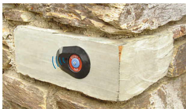
Caposaldo intelligente nero su muro fissato con rivetto e rondella identificativa.
